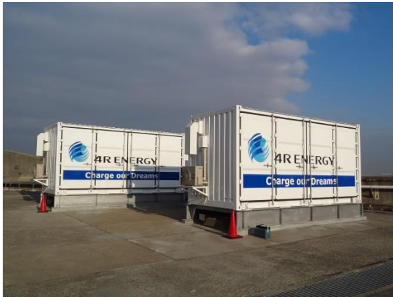
蓄電池システム全景
